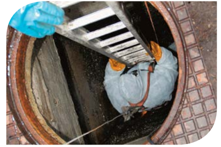
De nieuwe inspectie geeft meer inzicht in het moment en de noodzaak van een eventuele renovatie of vervanging. (foto: BvBeeld/Stichting RIONED)
